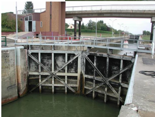
Fermeture des portes « busquées » d'une écluse à sas
